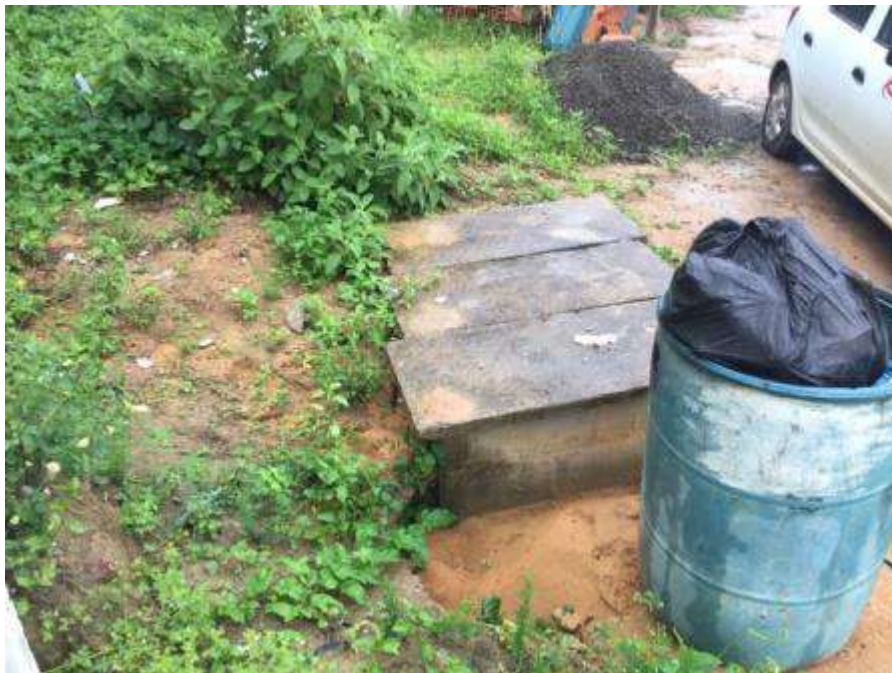
Figura 29 - Poço 1: Bairro Centro (Av. Cricaré) - Sist. São Mateus. Fonte: PMSB, 2019.
