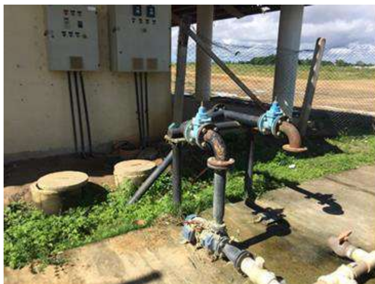
Figura 106 - Poços e Quadro de Comando – Sist. Village. Fonte: PMSB, 2019.
