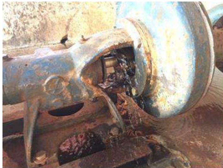
Figura 131 - Vazamento no Recalque de Água Tratada – Sistema Km 35. Fonte: PMSB, 2019.
