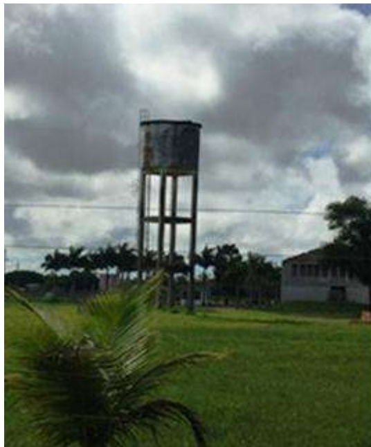
Figura 103 - Reservatório – Sist. Litorâneo. Fonte: PMSB, 2019.
