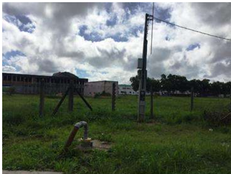
Figura 101 - Poço Principal – Sist. Litorâneo. Fonte: PMSB, 2019.
