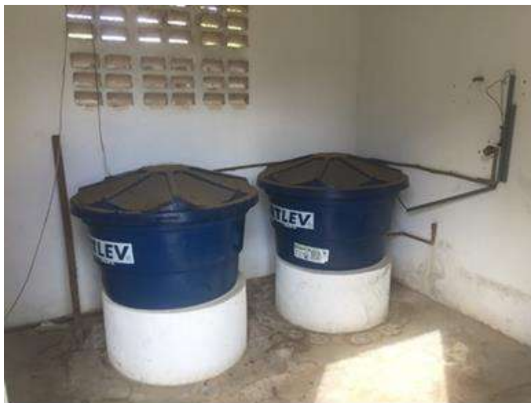
Figura 115 - Casa de Química – Sistema Km 13. Fonte: PMSB, 2019.
