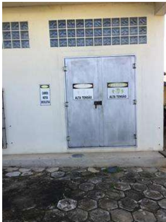
Figura 71 - Sub-estação. Fonte: PMSB, 2019.
