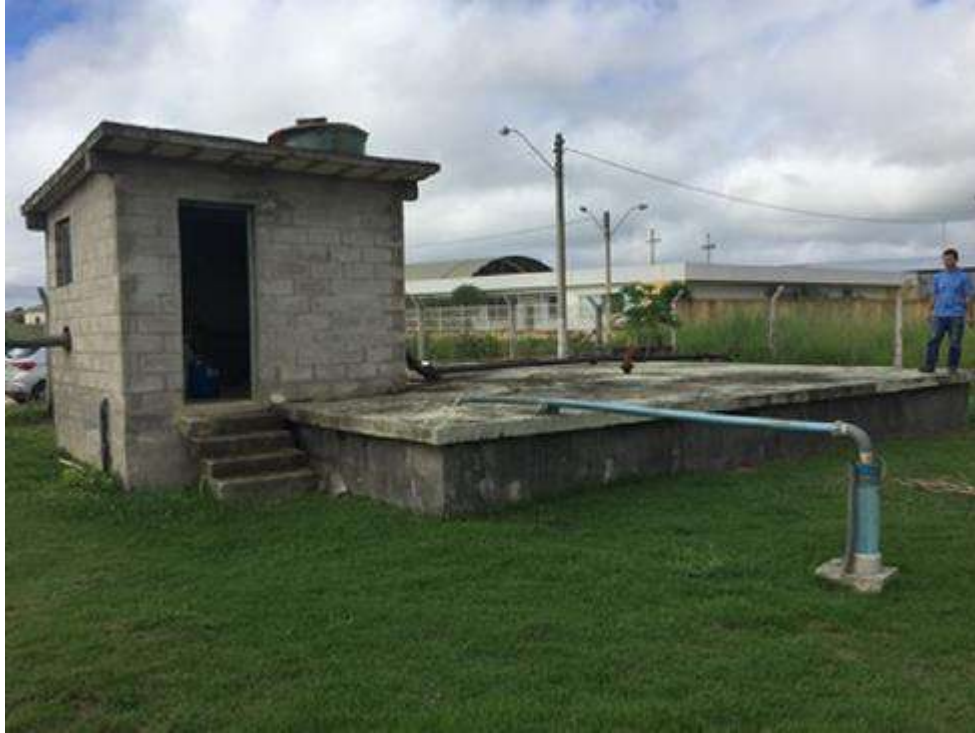
Figura 76 - Reservatório Parque das Brisas. Fonte: Biancade Engenharia, 2023.
