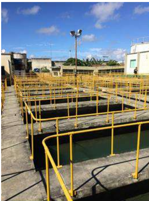
Figura 60 - Filtros Ascendente ETA 2. Fonte: Biancade Engenharia, 2023.
