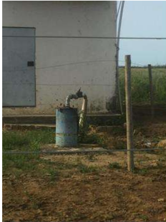
Figura 151 - Poço – Sistema Nova Lima. Fonte: PMSB, 2019.
