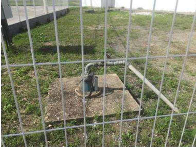
Figura 102 - Poço de Reforço – Sist. Litorâneo. Fonte: PMSB, 2019.
