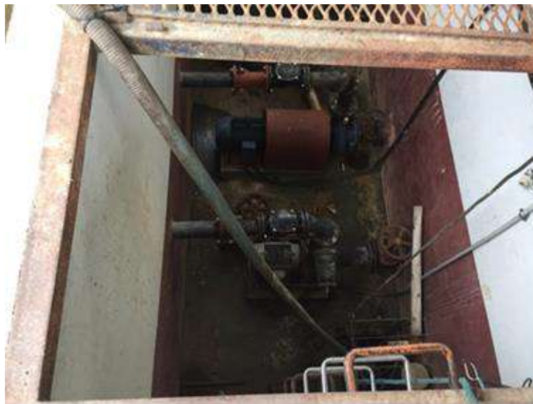
Figura 85 - ERAB – Poço 4. Fonte: PMSB, 2019.
