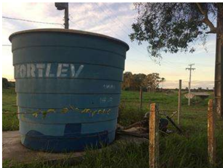
Figura 184 - Reservatório – Comunidade Ferrugem. Fonte: PMSB, 2019.
