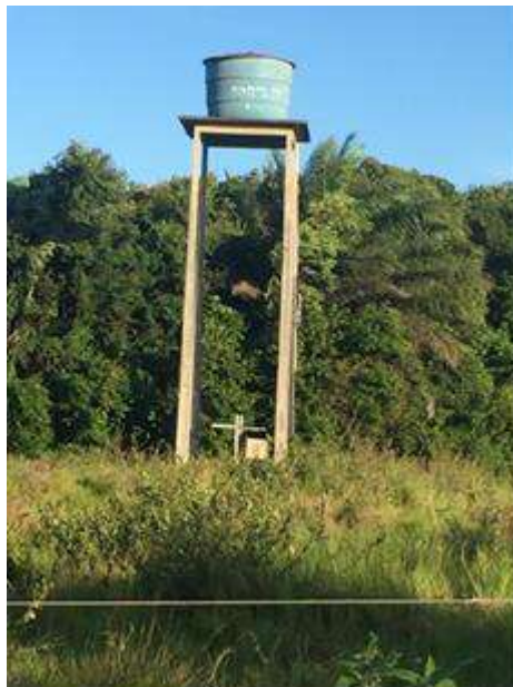
Figura 182 - Poço e Reservatório – Comunidade São Miguel. Fonte: PMSB, 2019.
