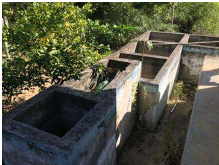
Figura 128 - Vista 1 ETA – Sistema Km 35. Fonte: PMSB, 2019.
