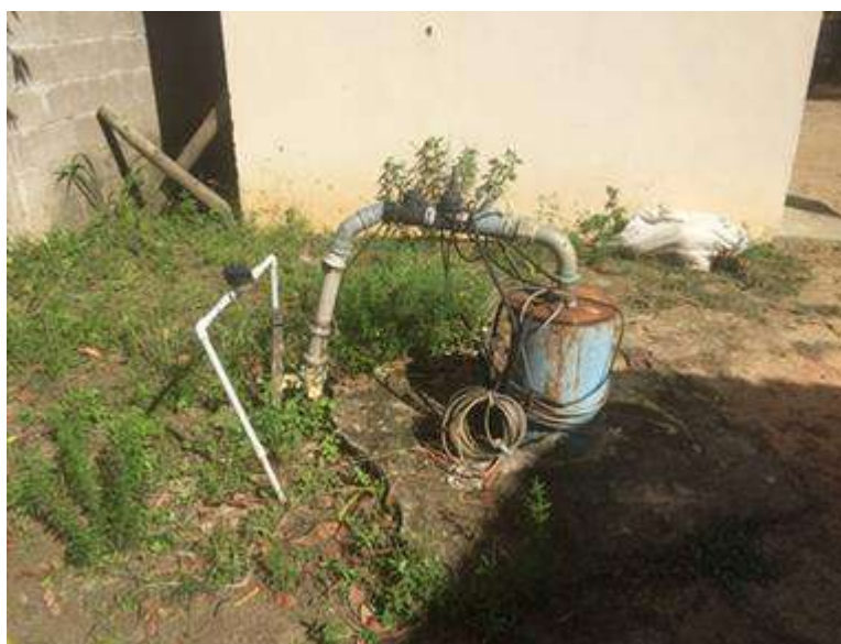
Figura 114 - Poço – Sistema Km 13. Fonte: PMSB, 2019.
