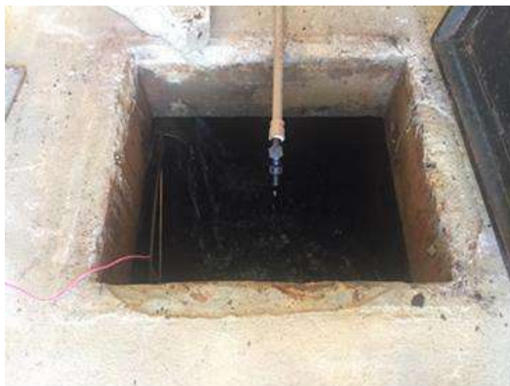
Figura 119 - Tanque de Contato – Sistema km 23. Fonte: PMSB, 2019.
