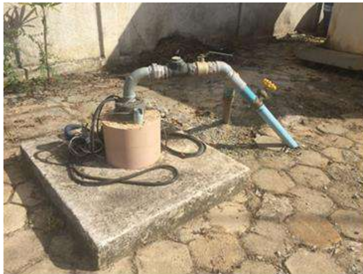
Figura 118 - Poço – Sistema km 23. Fonte: PMSB, 2019.
