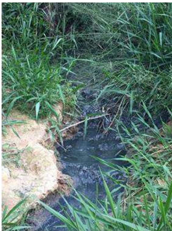
Figura 216 – Vazamento na rede - ETE Nestor Gomes. Fonte: PMSB, 2019
