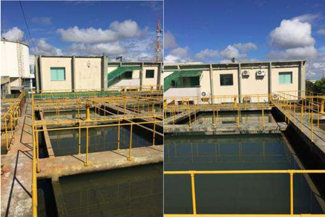
Figura 57 - Decantadores - ETA's 1 e 2. Fonte: PMSB, 2019.
