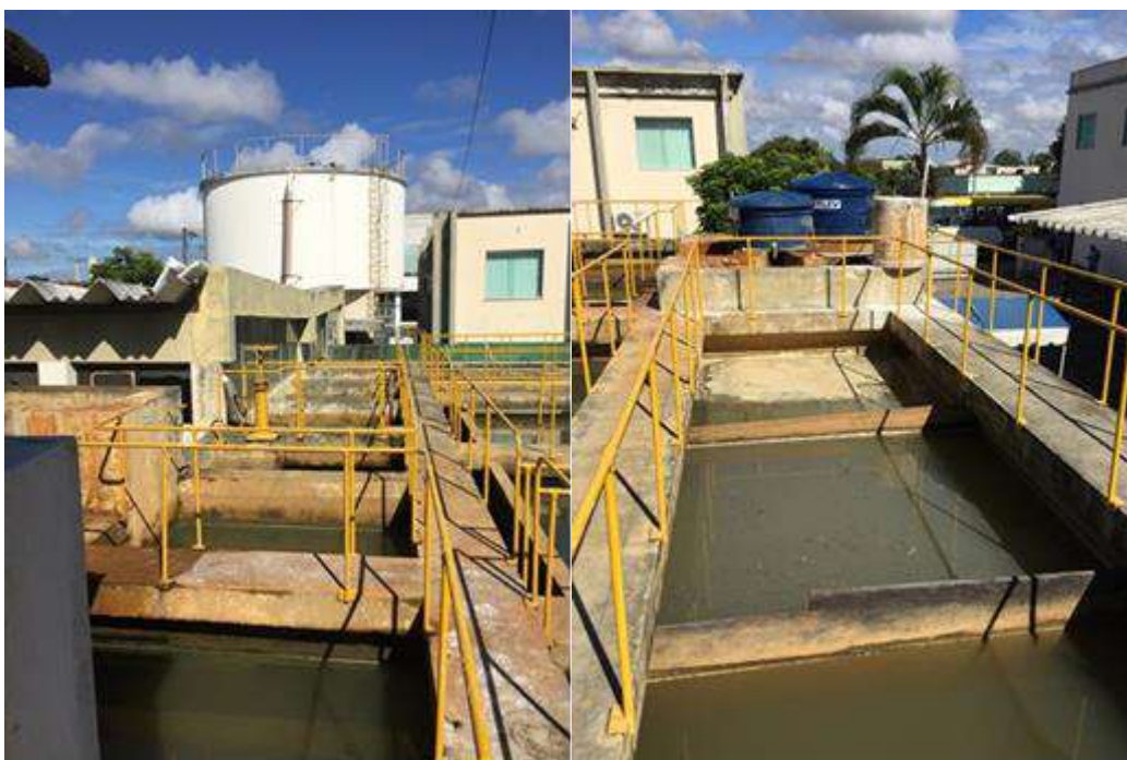
Figura 56 - Floculadores - ETA's 1 e 2. Fonte: Biancade Engenharia, 2023.
