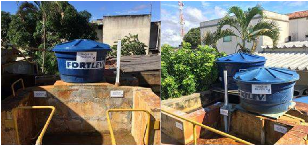
Figura 53 - Caixa de chegada ETA's 1 e 2. Fonte: PMSB, 2019.
