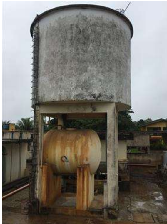
Figura 98 - Reservatório Sist. Guriri. Fonte: PMSB, 2019.
