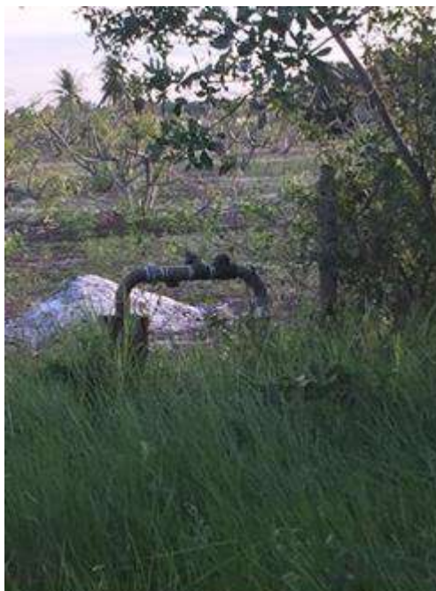
Figura 180 - Poço – Comunidade Nativo. Fonte: PMSB, 2019.
