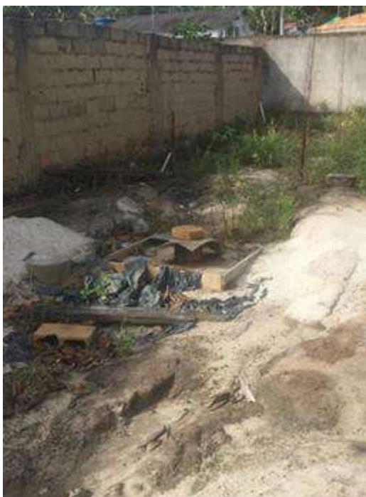
Figura 144 - Poço 2 – Sistema Itauninhas. Fonte: PMSB, 2019.
