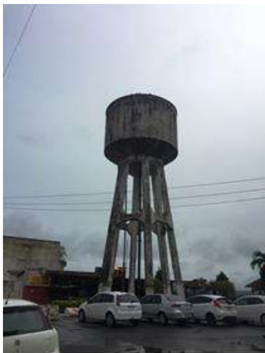
Figura 187 - Reservatórios de Vila Nova e Centro (desativados por comprometimento estrutural e de tubulações). Fonte: PMSB, 2019.
