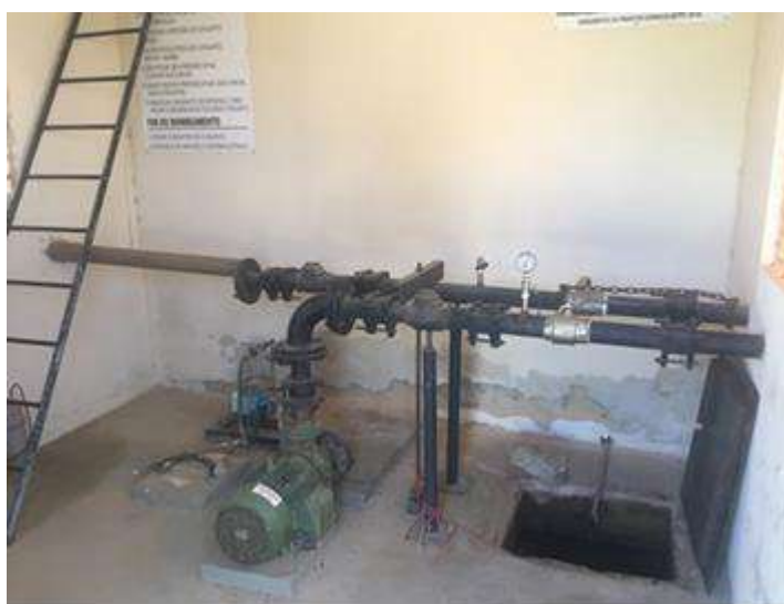
Figura 120 - Bomba de Recalque – Sistema Km 23. Fonte: PMSB, 2019.
