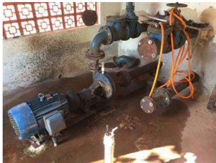
Figura 130 - Recalque de Água Tratada – Sistema Km 35. Fonte: PMSB, 2019.
