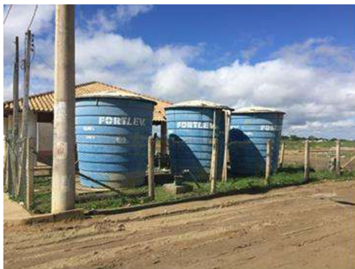
Figura 107 - Reservatórios – Sist. Village. Fonte: PMSB, 2019.
