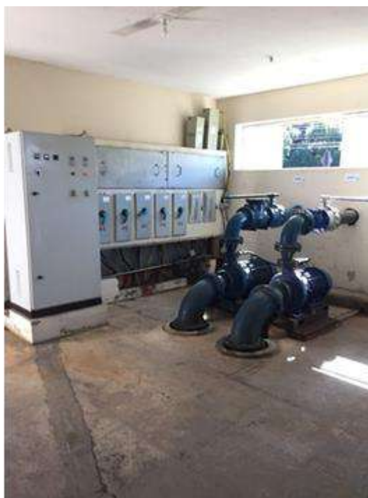
Figura 67 - Painéis de Controle e Conjuntos Motobombas 1 e 2. Fonte: PMSB, 2019.
