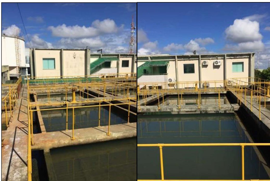
Figura 13 – Decantadores - ETA's 1 e 2 Fonte: Premier Engenharia, 2019.
