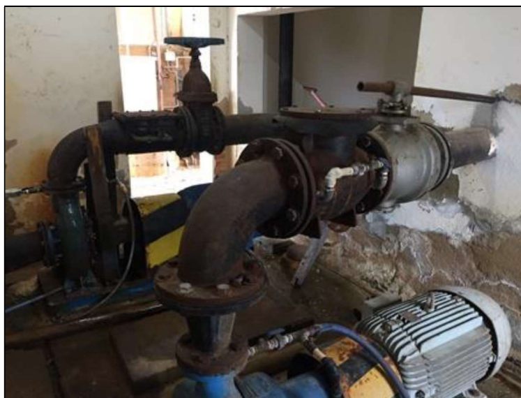
Figura 24 – Conjunto Motobomba - ERAT ETA Guriri Fonte: Premier Engenharia, 2019.
