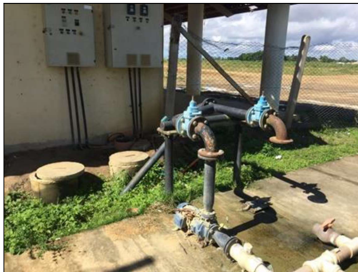
Figura 30 – Poços - Sistema Village Fonte: Premier Engenharia, 2019.
