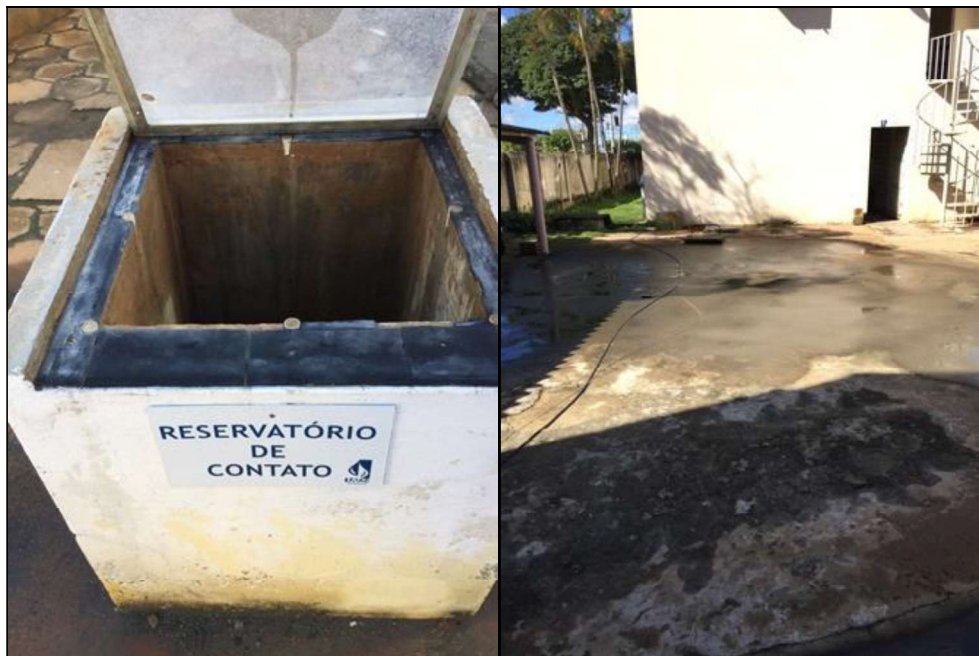
Figura 15 – Tanque de Contato Fonte: Premier Engenharia, 2019.
