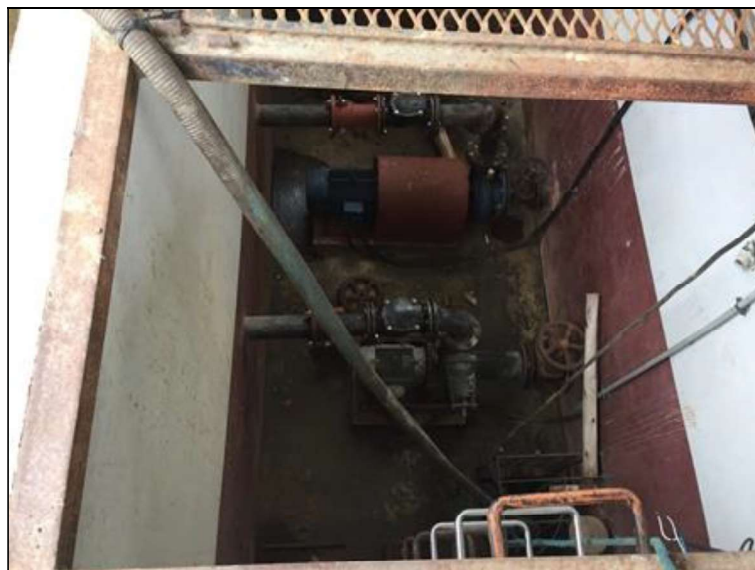
Figura 21 – ERAB - Poço em operação Fonte: Premier Engenharia, 2019.
