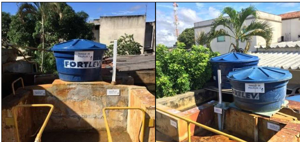
Figura 11 – Caixa de chegada ETA's 1 e 2 Fonte: Premier Engenharia, 2019.
