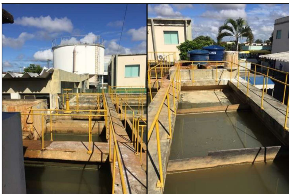
Figura 12 – Floculadores - ETA's 1 e 2 Fonte: Premier Engenharia, 2019.
