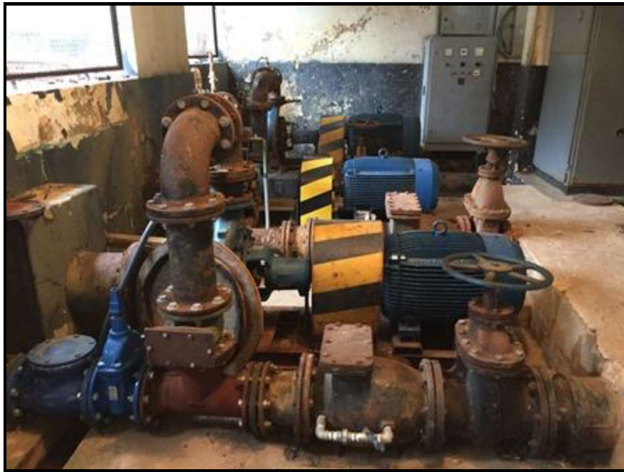
Figura 8 – Conjuntos motobomba - EEAB Fonte: Premier Engenharia, 2019.
