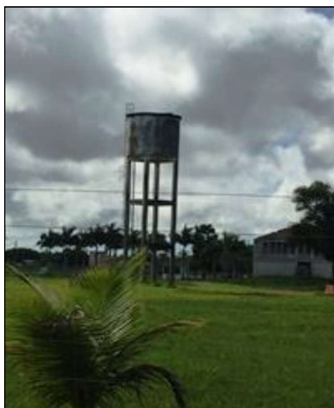
Figura 28 – Reservatório - Sist. Litorâneo Fonte: Premier Engenharia, 2019.
