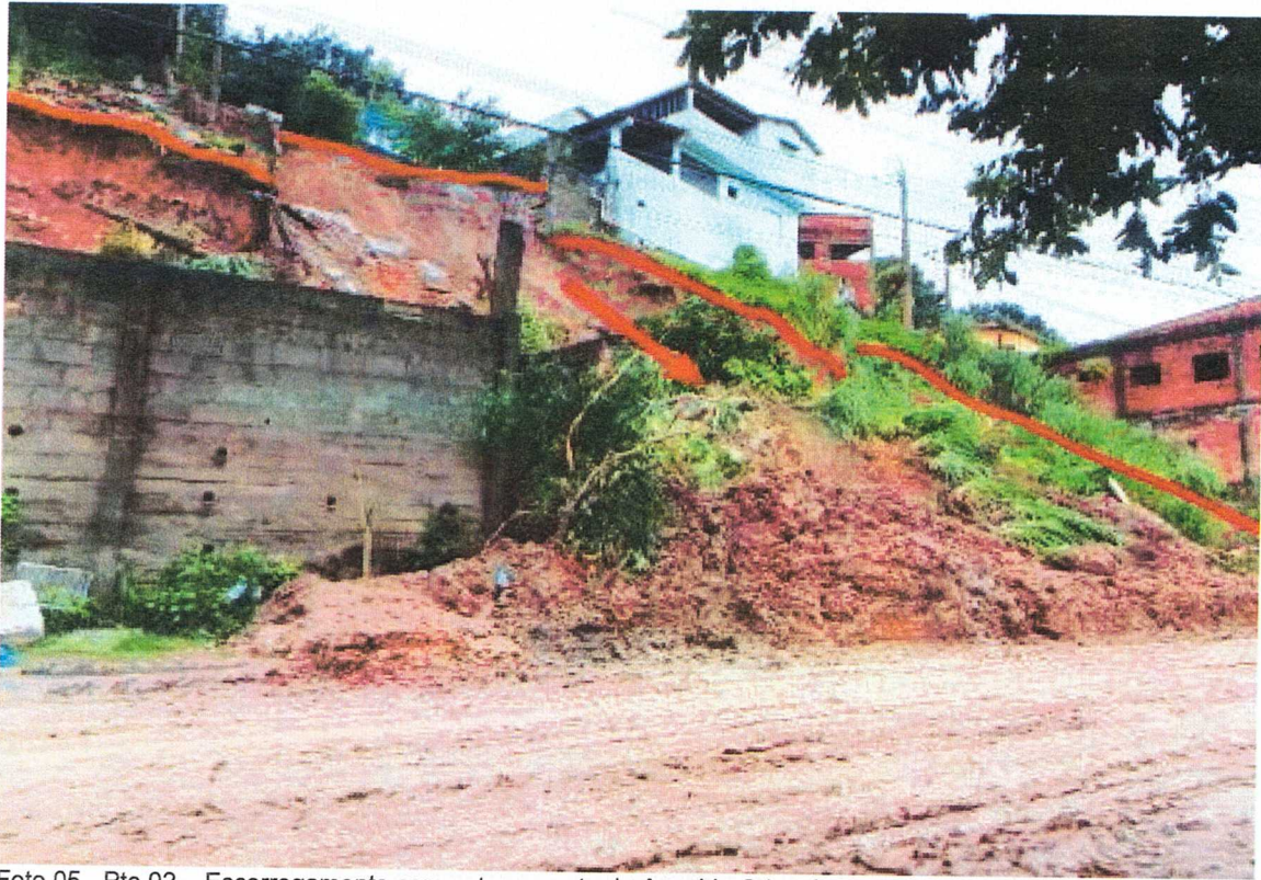
Foto 05 - Pto 02 – Escorregamento com soterramento da Avenida Cricaré
