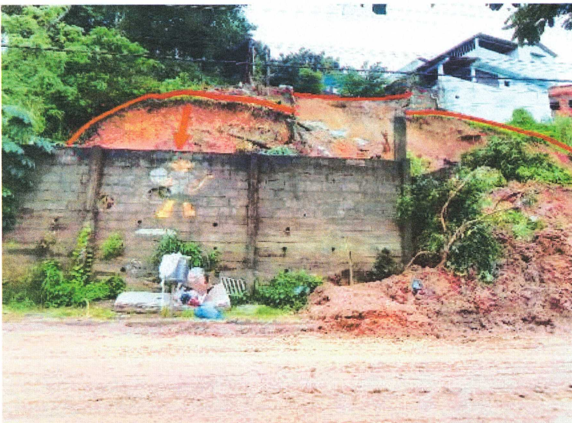
Foto 04 - Pto 02 – Cicatriz de escorregamento atrás do muro da propriedade
