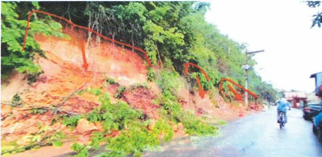
Foto 03 - Pto 02 – Conjunto de movimentos de massa gravitacionais com atingimento da margem da Avenida Cricaré
