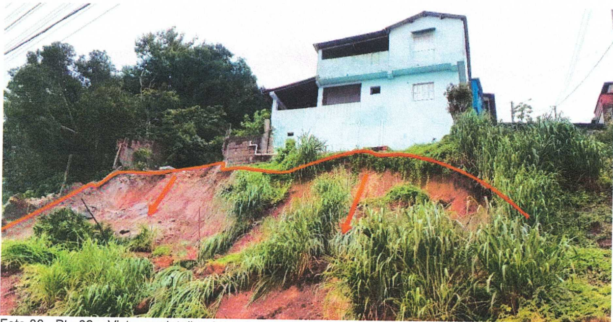
Foto 06 - Pto 02 – Vista em detalhe do escorregamento na base do imóvel, com risco iminente de novas movimentações e avarias na estrutura
