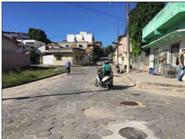
Figura 81 – Área Problema 1: Rua Hélio Orlandi (sujeita a alagamento) Fonte: Premier Engenharia, 2019.
