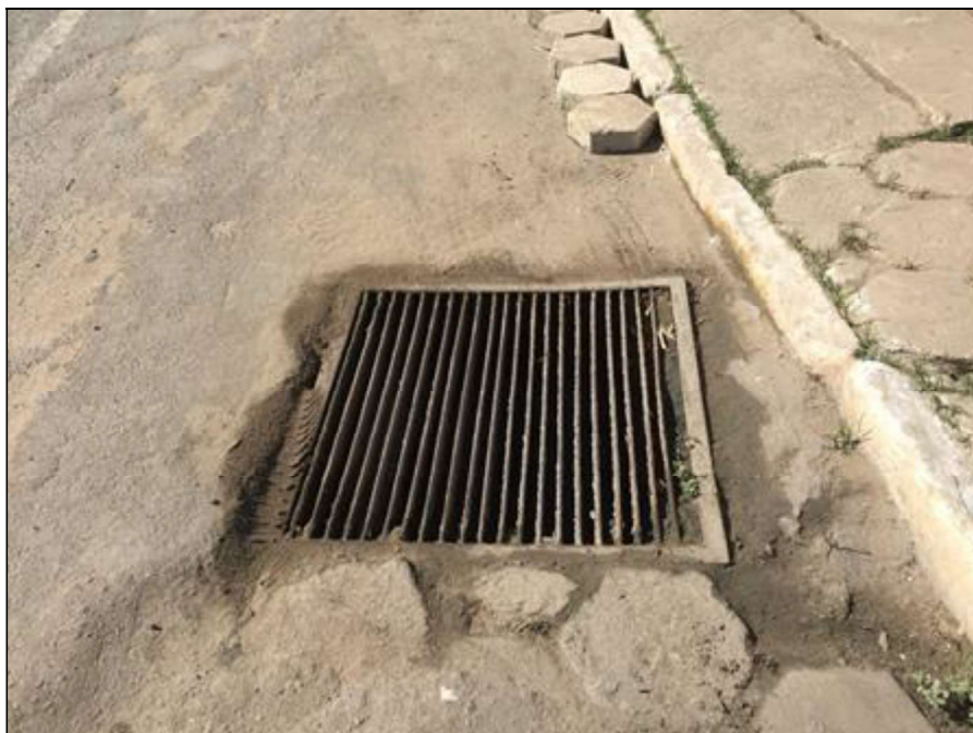
Figura 76 – Boca-de-lobo quadrada (com areia em excesso) - Guriri Fonte: Premier Engenharia, 2019.
