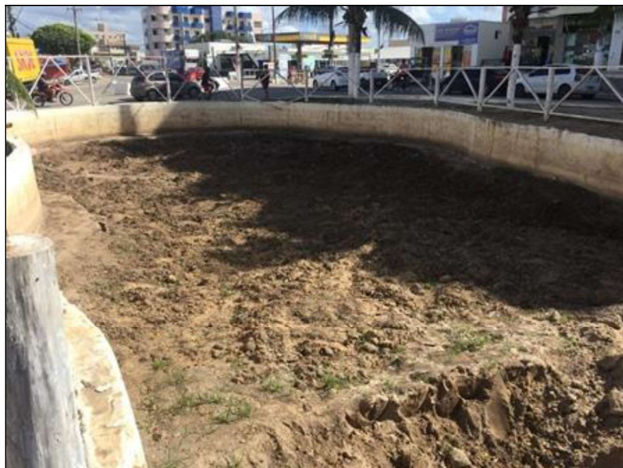
Figura 88 – Área Problema 3: bacia de contenção na Avenida Guriri Fonte: Premier Engenharia, 2019.
