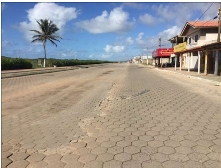
Figura 87 – Área Problema 3: Av. Oceano Atlântico (sem drenagem) Fonte: Premier Engenharia, 2019.
