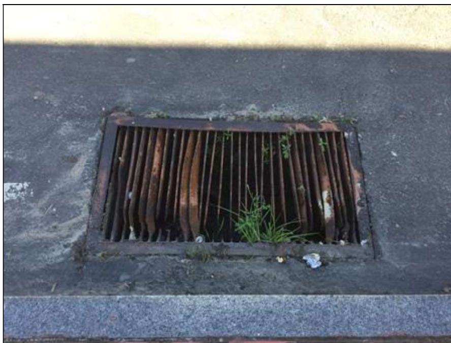
Figura 75 – Boca-de-lobo retangular com grelha de ferro (em mau estado de conservação) – Bairro Boa Vista Fonte: Premier Engenharia, 2019.
